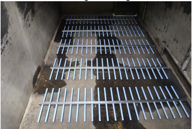
Rampes d'insufflation d'air (vue dans un bassin d'aération vide)
