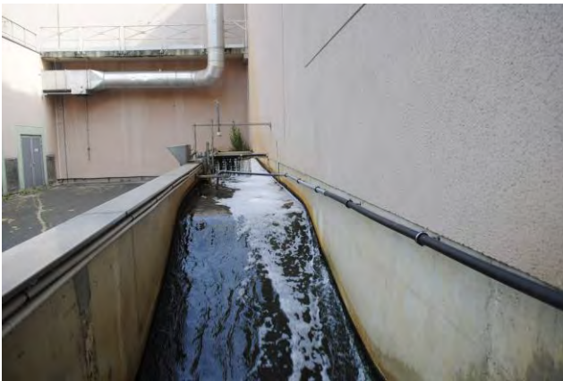
Canal de comptage des eaux épurées (SIAH)
