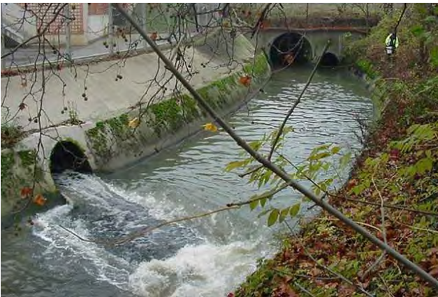
Rejet des eaux épurées dans la Morée (DEA93)
